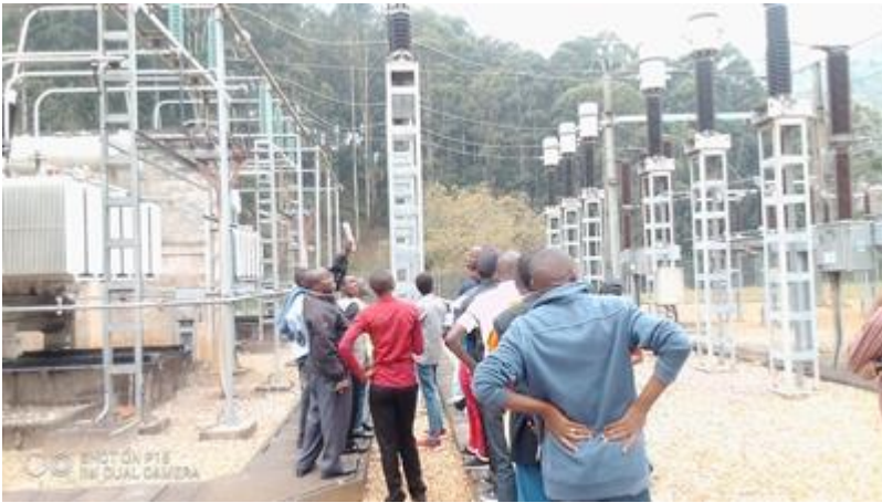
Photo 8: les infrastructures de transport d'électricité
